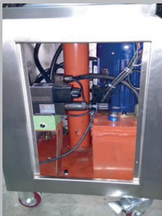
Grupo hidráulico de alta presión Tanque de aceite independiente
